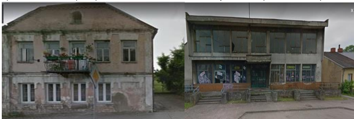
Rys 7. Stan techniczny budynków na Podobszarze I rewitalizacji - ul. Łomżyńska w Szczuczynie
